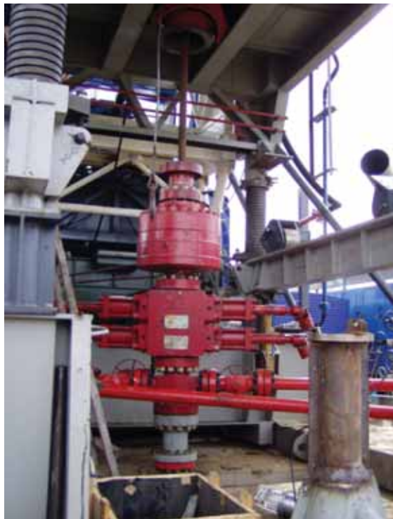
Монтаж ПВО ОП5-180/80x35 на мобильной буровой установке БУ2000/125-М-Д-2, изготовленной ООО «ВЗБТ» для «Славнефти», МУБР
