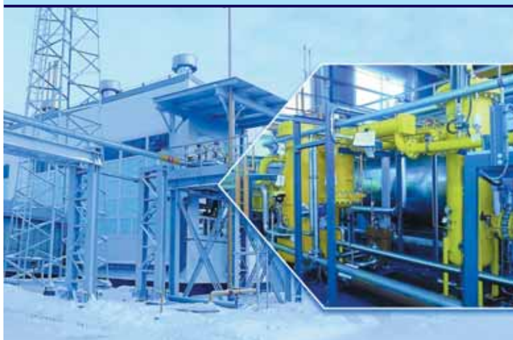
Фото 2. Установка подготовки топливного газа «ЭНЕРГАЗ» для ГТЭС-12 Игольско-Талового м/р (ОАО «Томскнефть»)
