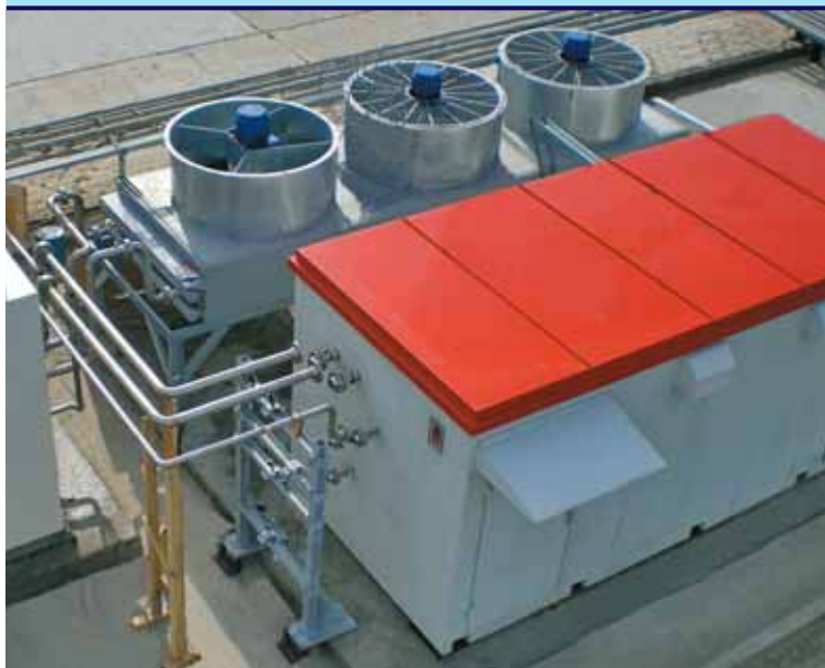
Фото 7. Адсорбционный осушитель газа на ЦПС Западно-Мугутлорского месторождения
