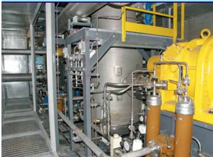
Фото 5. Компрессорная установка в арктическом исполнении
