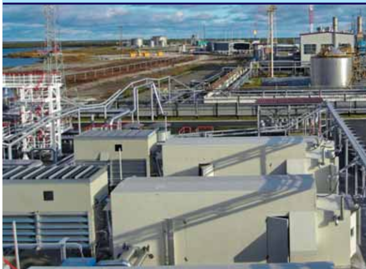
Фото 1. Компрессорные установки Биттемского месторождения (ОАО «Сургутнефтегаз») для транспортировки ПНГ
