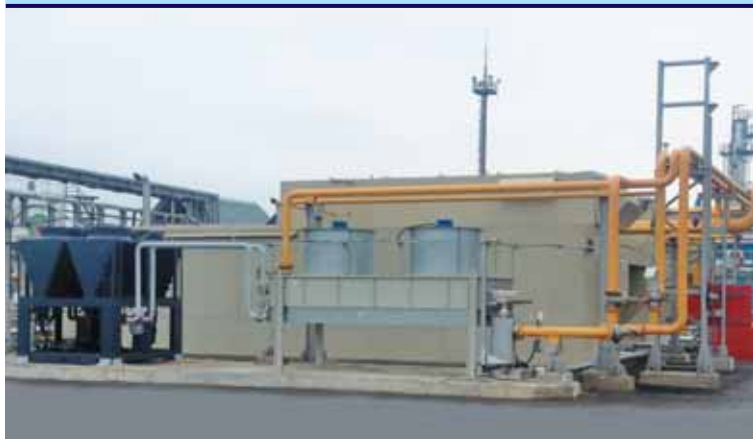
Фото 8. Рефрижераторная установка газоохлаждения в составе системы подготовки ПНГ
