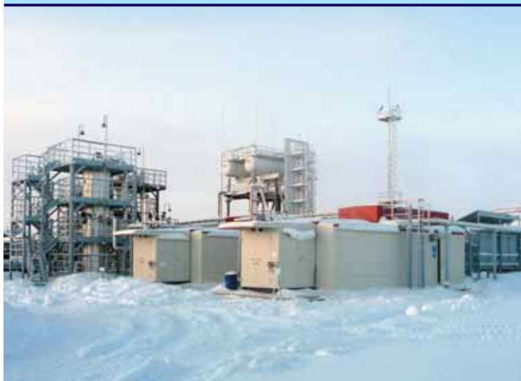
Фото 3. КУ низкого давления в составе СКНС Северо-Лабатьюганского месторождения
