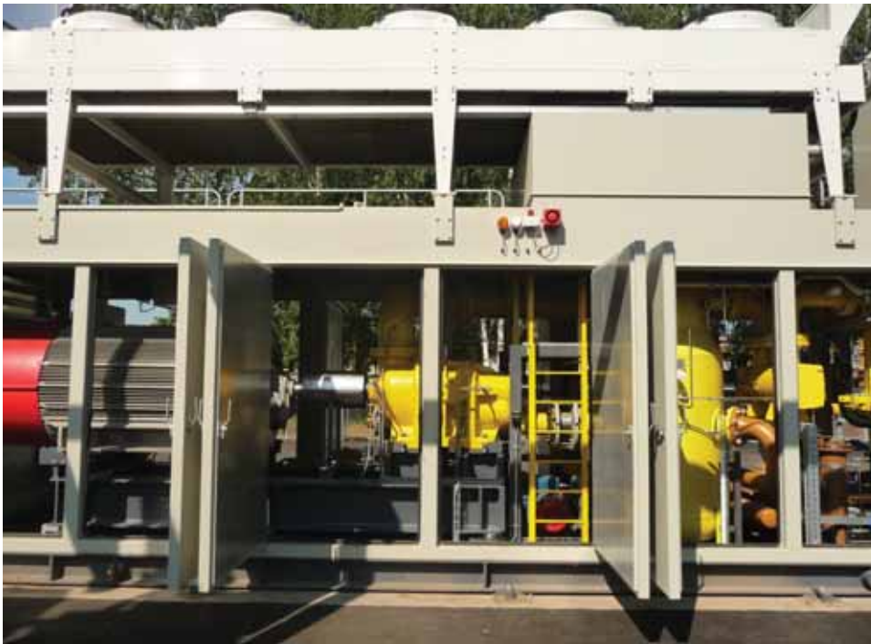
Система подготовки топливного газа от компании «ЭНЕРГАЗ» для турбин парогазовой установки Уфимской ТЭЦ-2
