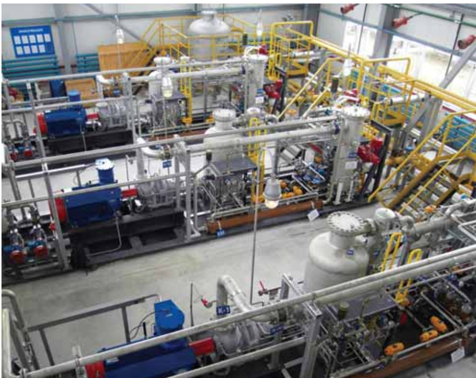
Первый проект по применению ДКУ Enerproject на нефтегазовых месторождениях (ГТЭС Конитлорского м/р)
