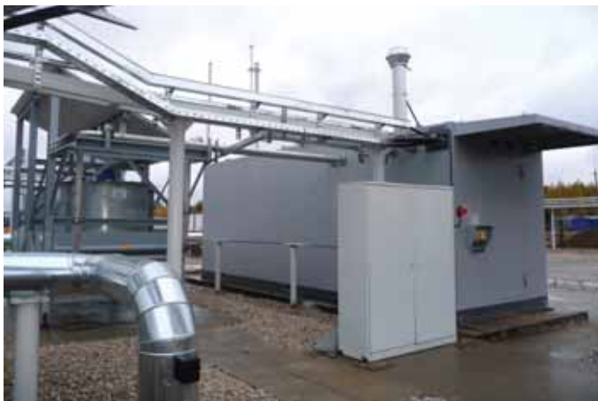
Газодожимная компрессорная установка низкого давления подготавливает ПНГ для ГТЭС Гежского м/р
