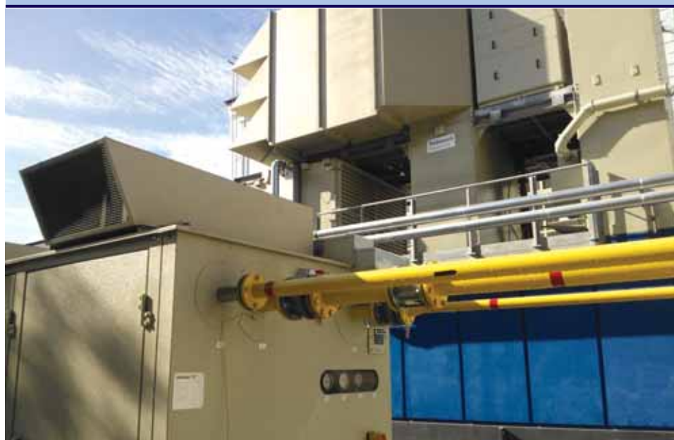
Фото 3. ГТЭС ОАО «Минский КСИ». ГТУ Turbomach и дожимная компрессорная установка
