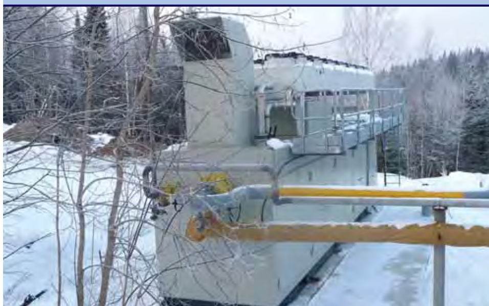
Фото 4. Оборудование газоподготовки на стенде для испытаний ГТУ «Авиадвигатель-ПМЗ»
