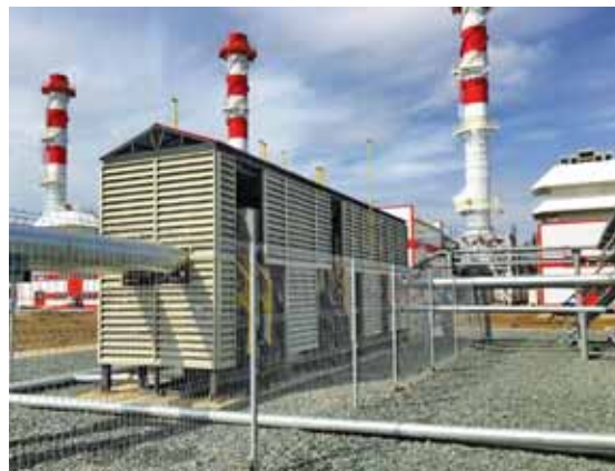
Фото 1. БПТГ «ЭНЕРГАЗ» для энергоцентра собственных нужд ООО «ЛУКОЙЛ-Коми» (ГТУ-ТЭЦ, Усинское месторождение)
