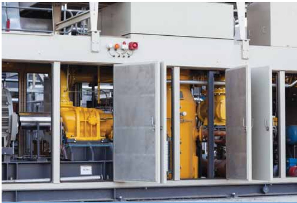
Фото 7. ДКС обеспечивает турбины газом с проектными параметрами по чистоте, давлению и температуре
