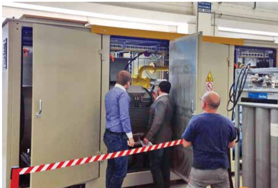
Фото 9. Заводские испытания оборудования газоподготовки для ПГУ ТЭЦ МЭИ с участием специалистов заказчика
