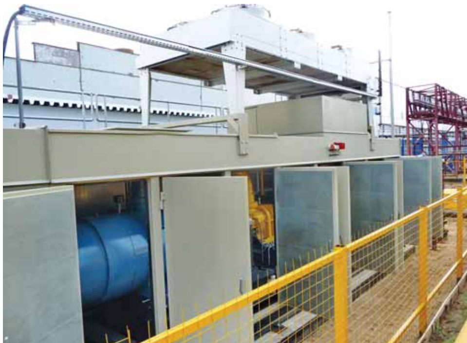
Фото 3. ДКС снабжает топливом испытываемые турбины и газоперекачивающие агрегаты
