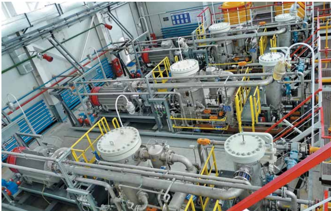
Фото 7. Оборудование подготовки и компримирования топливного газа «ЭНЕРГАЗ-Enerproject» для ГТЭС Рогожниковского месторождения
