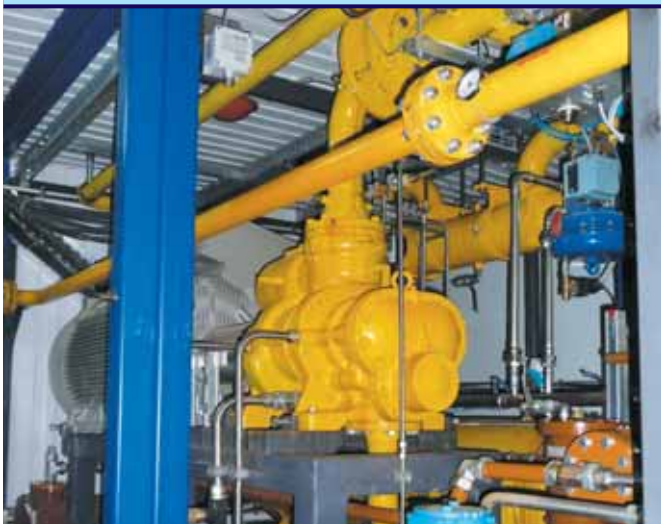
Фото 7. Газодожимное оборудование в основе УПТГ для ГТЭС Верх-Тарского месторождения
