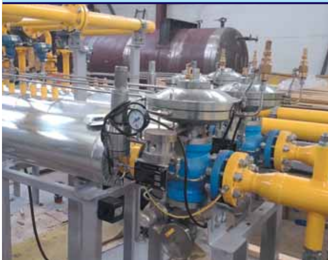
Фото 5. Линии редуцирования в составе СПТПГ для ДКС месторождения «Алан»
