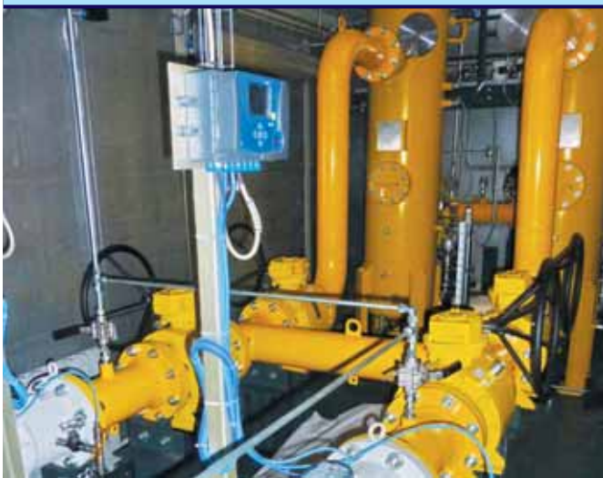
Фото 4. БПТГ в составе системы газоподготовки на ГТЭС-25 завода Kastamonu
